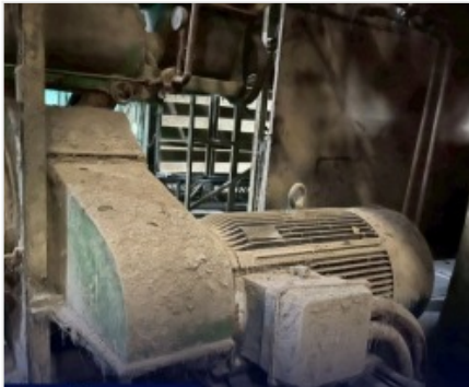
ร้านปริญญพร ประเมินตามสภาพจริง ไม่กดราคา ให้ราคาสูง รับซื้อแอร์чилเลอร์ เครื่องจักรใหญ่ หม้อแปลงไฟฟ้าใหญ่
